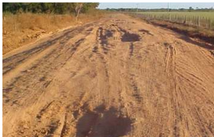
Grande quantidade de buracos ao longo do trecho. GO-116, trecho: Forte/ Entronc.GO-236.
