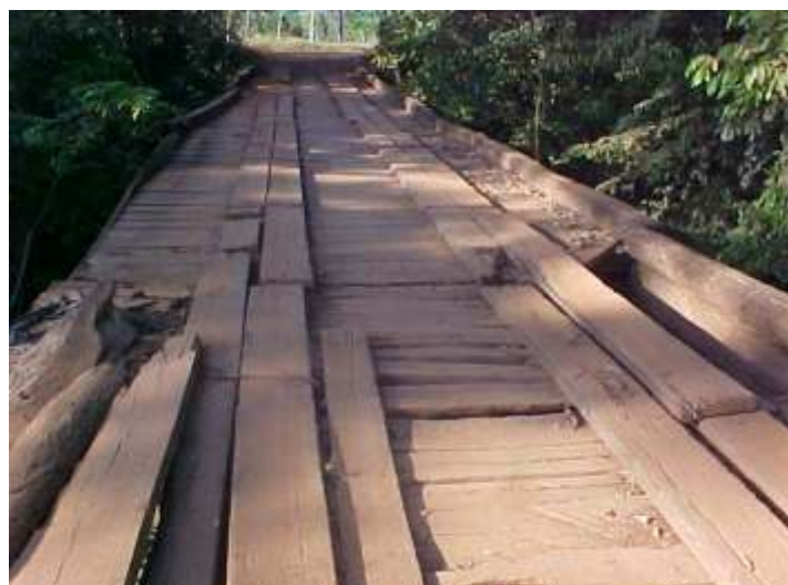
Ponte em madeira - Pranchões e vigas danificadas. Buracos no tabuleiro. GO-116, trecho: Forte/ Entronc.GO-236
